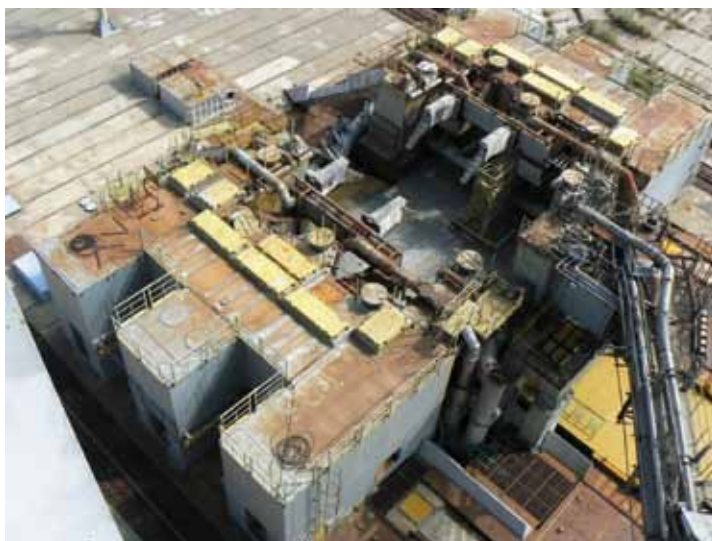
Пусковое устройство Пусковой стол УКСС пл.250 предназначенный для запуска ракет-носителей «Энергия» с различными КА подлежит демонтажу и установке сменного пускового стола для ракет-носителей класса «Ангара»
